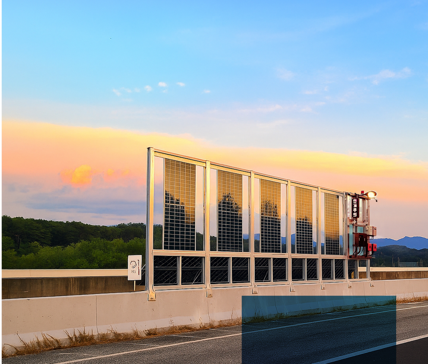
한국도로공사 여주시험도로 신재생에너지 신기술 상용화 테스트베드 현장
