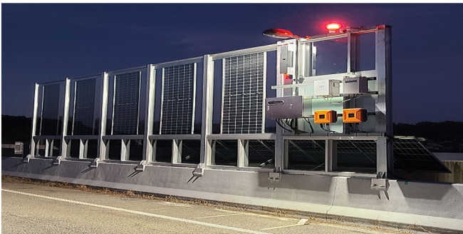
한국도로공사 여주시험도로, 태양광 및 인프라 방음벽(전면)
